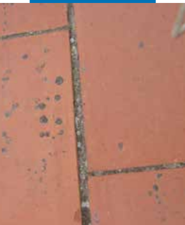
Stara okładzina z terakoty, która wymaga naprawy przez aplikacją powłoki Aquaflex Roof
