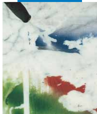
Czyszczenie marmuru karraryjskiego, na którym zastosowano WallGard Graffiti Barrier, wodą pod wysokim ciśnieniem
