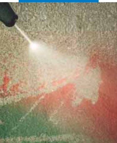
Czyszczenie betonu, na którym zastosowano WallGard Graffiti Barrier, wodą pod wysokim ciśnieniem
