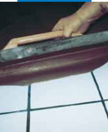
Rozprowadzanie masy Ultraplan na starym podłożu ceramicznym wcześniej zagruntowanym Mapeprim SP lub Primer G
