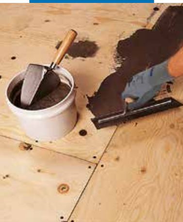
Szpachlowanie podłoża ze sklejki przy użyciu zaprawy Nivorapid zmieszanej z Latex Plus
